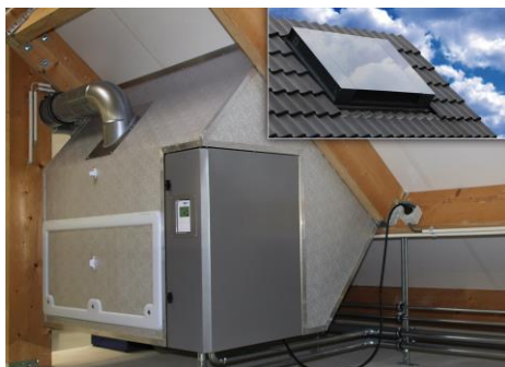
Figuur 9 Warmtepomp, boilervat en buitendeel in gecombineerde zolderunit
