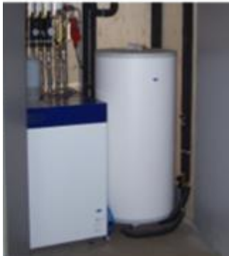
Figuur 10 Warmtepomp en boilervat naast elkaar
